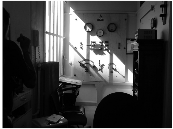
写真12 保存されている制御室
